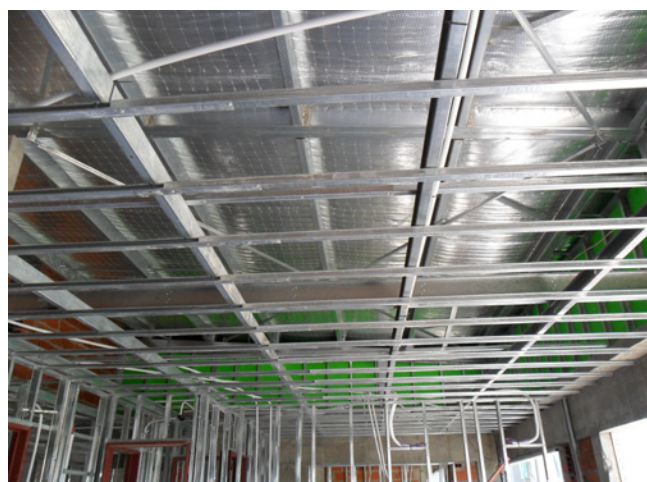
Utilización Filtro Tensado Alu en cubierta.
